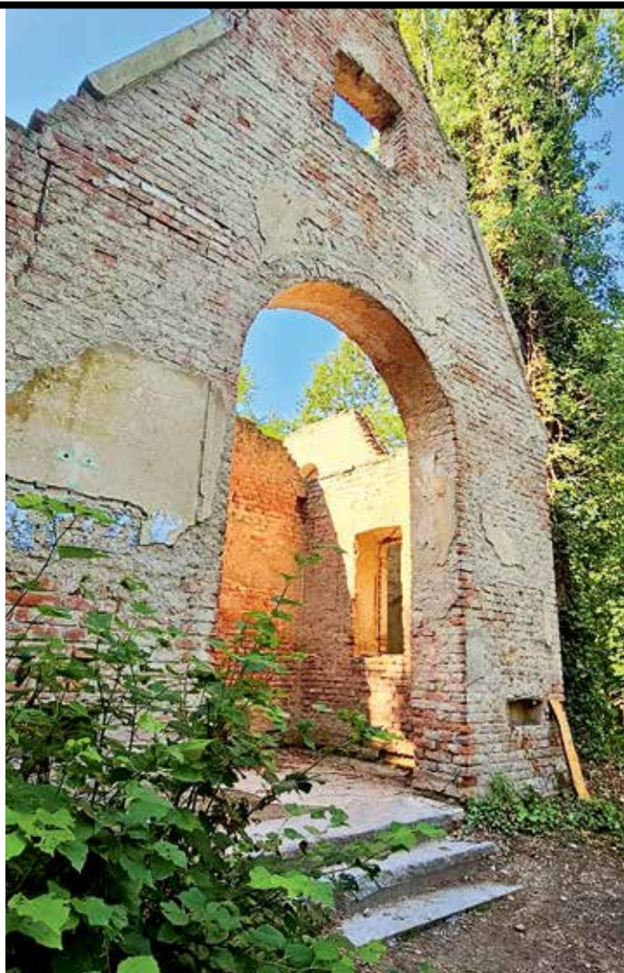
▲ Z kaple po „aktivitách“ vandalů a následném požáru zbyly jen obvodové zdi
