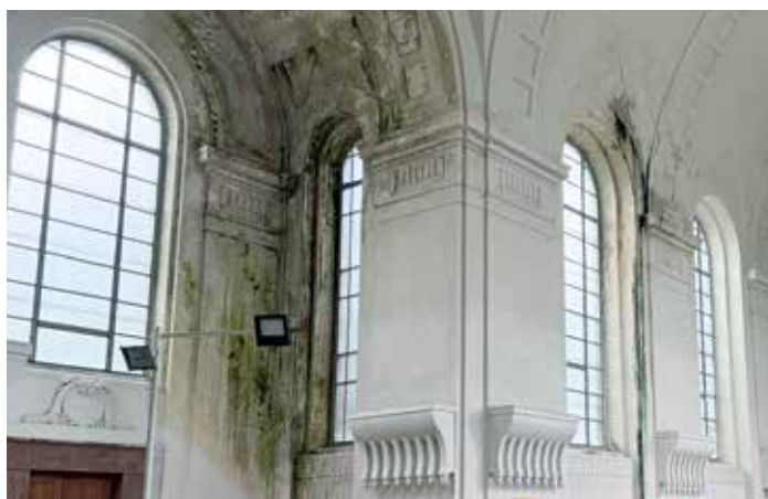
▲ Zdivo a omítky kostela poškozuje vlhkost
