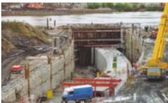
Betonový tubus pro trasu metra IV.C1, který byl vysunut pod hladinu Vltavy.
